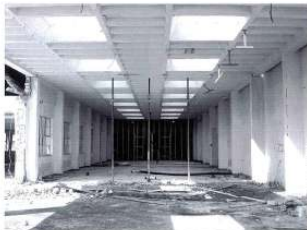
Vor der Sanierung hatten partieller Abbruch und unterschiedliche Nutzungen die ursprüngliche Struktur empfindlich gestört
